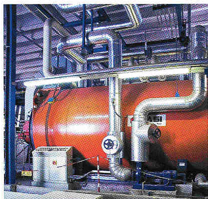
CALDAIA DI RISERVA E INTEGRAZIONE
